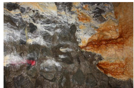
Im Inneren einer Bruchsteinmauer. Die örtlich sich stark ändernde Kalkablagerung als Folge von Durchsickerungen ist deutlich zu erkennen. (Foto: Prof. Dr. Tom Lahmer)
