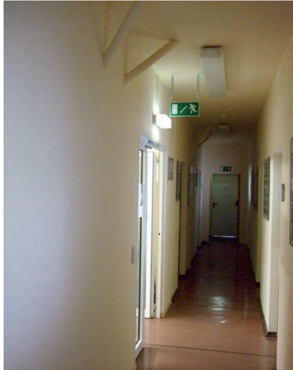
Flur im 1. Obergeschoss mit Rettungszeichenleuchte
