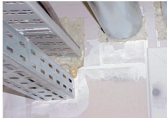
Brennbare Einbauten im Flur
