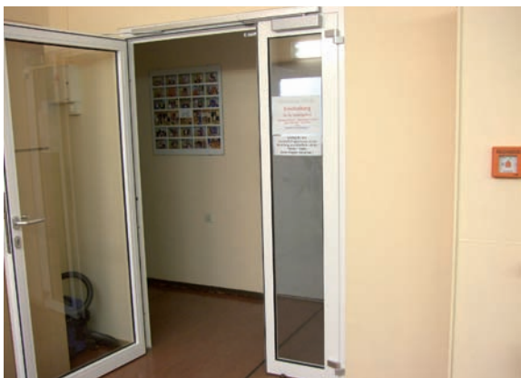
1. Obergeschoss – Treppenraum mit Rauchschutztür und Feststellanlage
