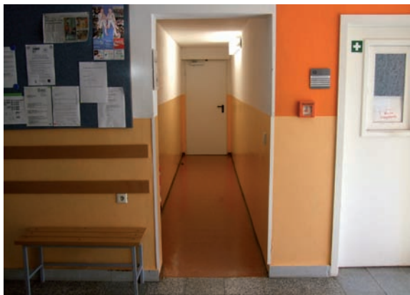
Erdgeschoss – Flurbereich mit dicht- und selbstschließenden Türen
