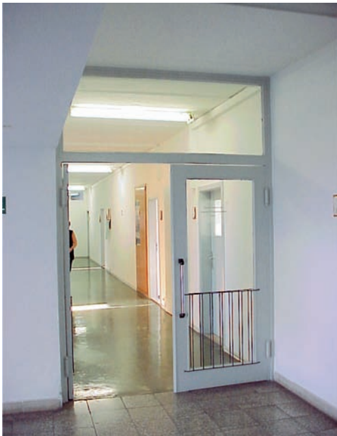
Nicht brandschutztechnisch abgetrennte Flure zum Treppenraum
