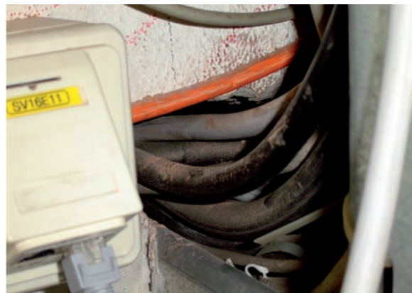
Nicht ordnungsgemäß geschottete Installationsdurchführungen
